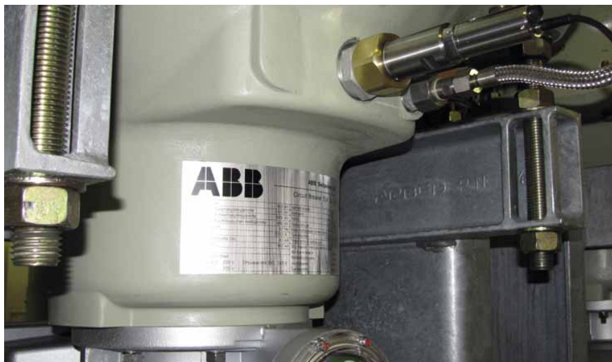
Figure 5. Installation d'un capteur de point de rosée, pression et température (DPT145) directement sur le réservoir de gaz principal (25.3 – 14.4.2010). Le volume de gaz contenu dans la cellule de mesure est d'environ 20 ml.
