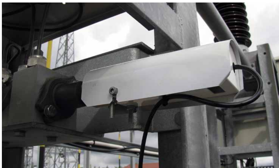
Figure 2: Installation extérieure dans un "bloc capteur".
