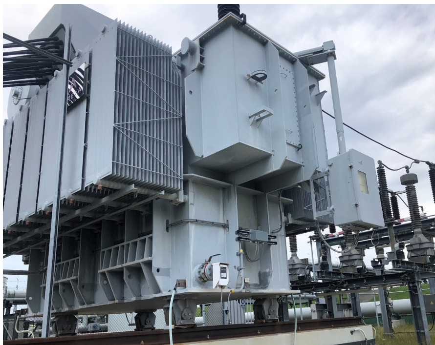
Installazione Vaisala MHT410 presso il trasformatore della centrale elettrica Bio Golden Raand di Eneco nei Paesi Bassi
