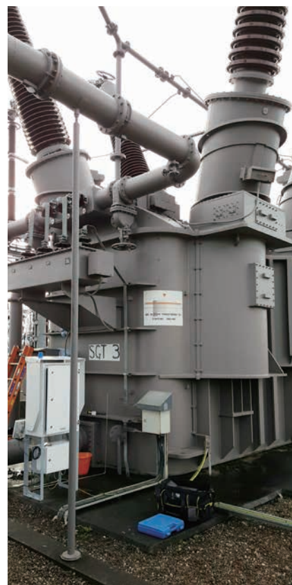
電力用変圧器に設置されたヴァイサラのOptimus™ 絶縁油中ガス・水分オンライン監視装置
