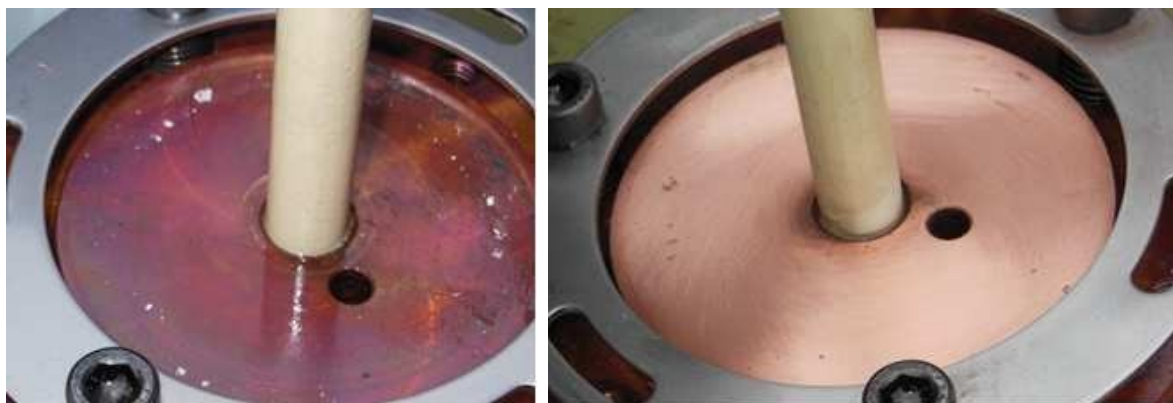
Figura 1 Casquillo y contacto principal de la salida de bobinado de 110 kV 2a que desencadenaba el fallo, antes y después de la reparación.
